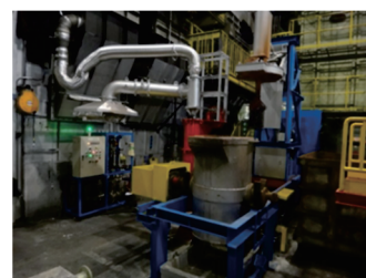
不純物金属（マンガン等） 除去装置
